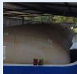
4. Biodigestor tratamiento aguas residuales en 10 celdas anaeróbicas
