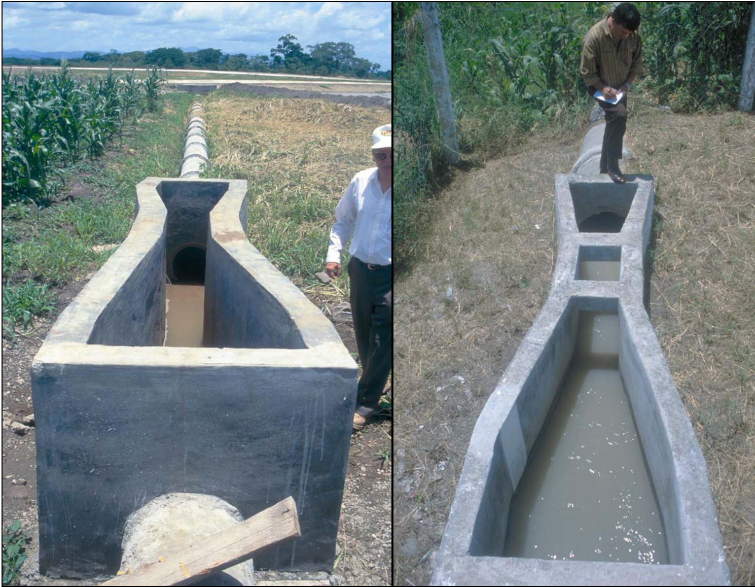
Fotos 3-12: Ejemplos de canaletas Parshall de concreto que no sirven por su mala construcción (nótese las dimensiones irregulares) y el hecho que no cuentan con flujo libre como se ve en las Fotos 3-11. Nunca se debe diseñar canaletas Parshall de concreto. (Foto izquierda: Catacamas, Honduras; derecha: Villanueva, Honduras)
