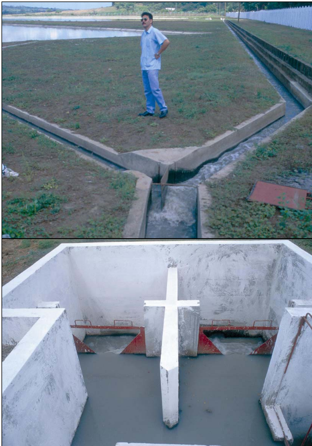
Fotos 6-12: Ejemplos de dispositivos para la repartición de caudales entre baterías de lagunas facultativas en paralelo. En la foto arriba (Masaya, Nicaragua), se utiliza un tabique divisorio ajustable, y en la foto abajo (Granada, Nicaragua), un tabique divisorio combinado con vertederos triangulares ajustables. Se debe medir los caudales a cada laguna para estar seguro de la repartición.
