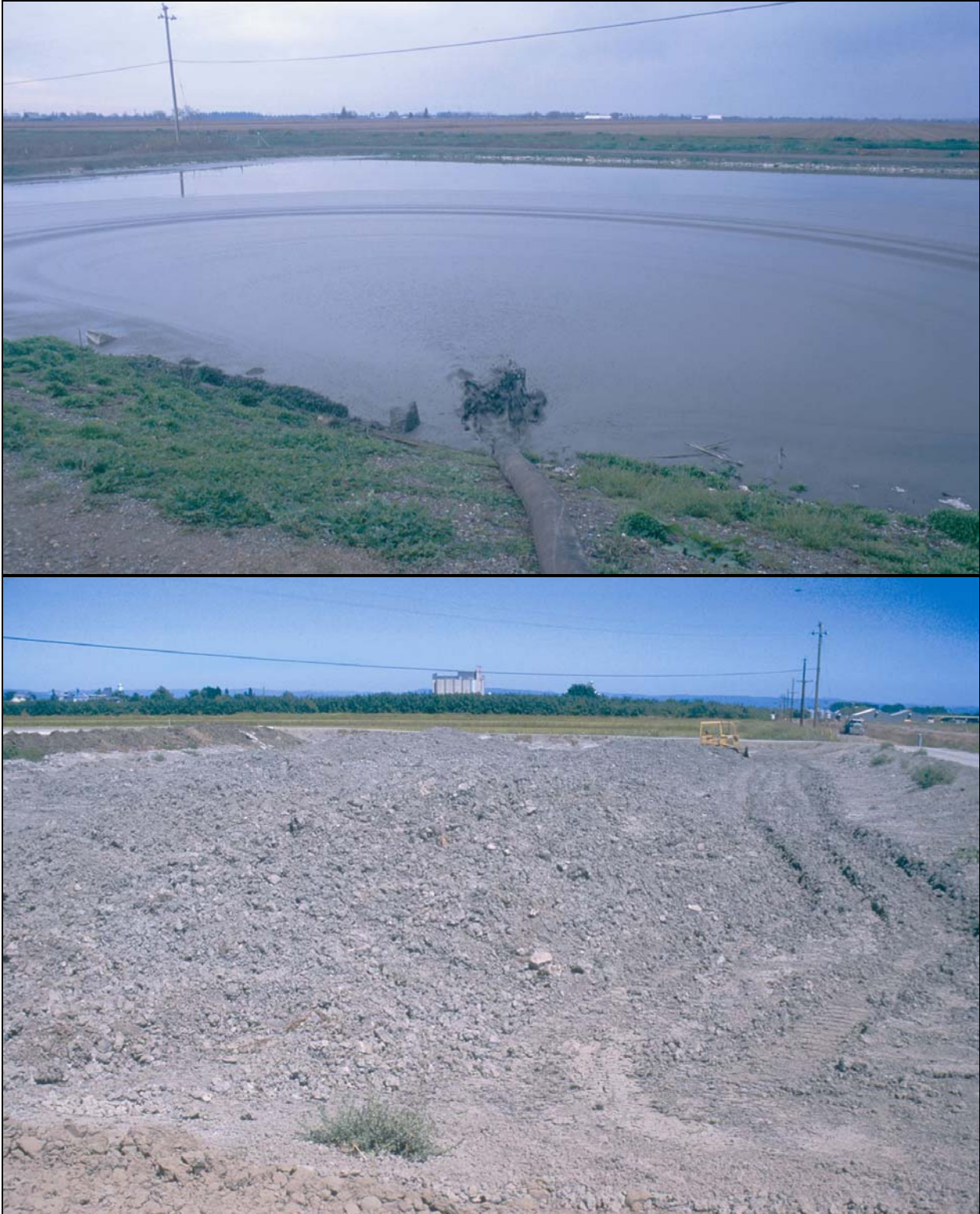
Fotos 8-5b: El lecho de secado recibiendo los lodos bombeados de la laguna primaria (foto arriba) y los lodos dos meses después de secar (foto abajo). El lecho de secado fue construido con un drenaje para los lixiviados, lo que llevaba los lixiviados a la otra laguna en operación. Después de secar los lodos fueron llevados a un relleno sanitario. (Biggs, California)
