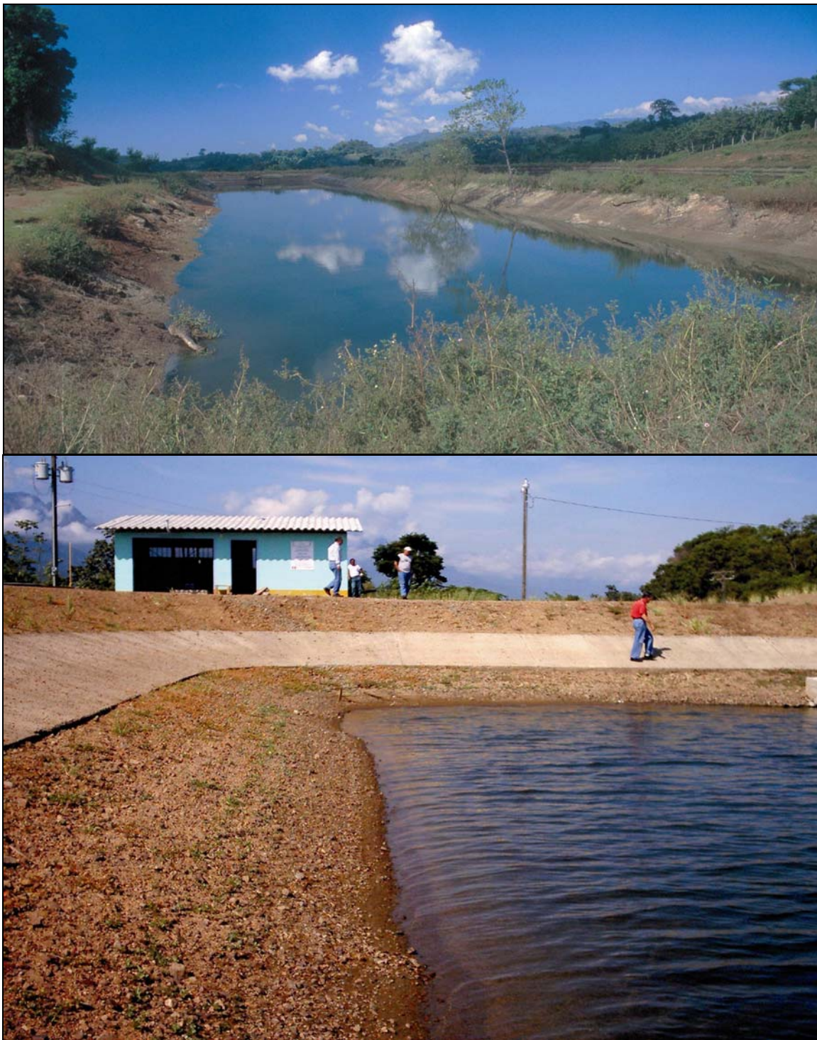
Fotos 6-4: Ejemplos de la importancia del balance hídrico. En las dos fotos las pérdidas por infiltración son excesivas y no se puede mantener el nivel de agua en las lagunas. Las dos lagunas faltan impermeabilización adecuada de arcilla. (Arriba: Zaragoza, El Salvador; abajo: La Ceiba, Honduras. Foto abajo cortesía de Ing. Iván Olivieri.)
