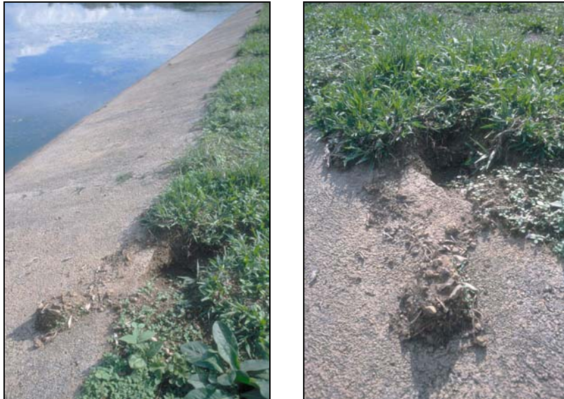
Fotos 7-11: Las tortugas pueden excavar atrás y abajo del revestimiento para depositar sus huevos. El operador debe monitorear la condición del revestimiento de rutina cuando hay poblaciones altas de tortugas. (Danlí, Honduras)
