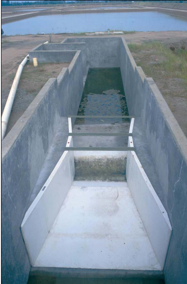
Foto 6-8: Una canaleta Parshall prefabricada, instalada correctamente, debe tener su respectiva lectura de caudal a la vista. La medición de caudales es fundamental para poder determinar la carga hidráulica y orgánica al sistema de lagunas. Un registro de caudales permite la evaluación de la eficiencia del tratamiento, el diagnóstico de una laguna que no funciona bien, la determinación de la magnitud de infiltración y las conexiones legales e ilegales al alcantarillado, y un cálculo aproximado de cuando el sistema de lagunas llegará a su capacidad de carga. (El Paraíso, Honduras)
