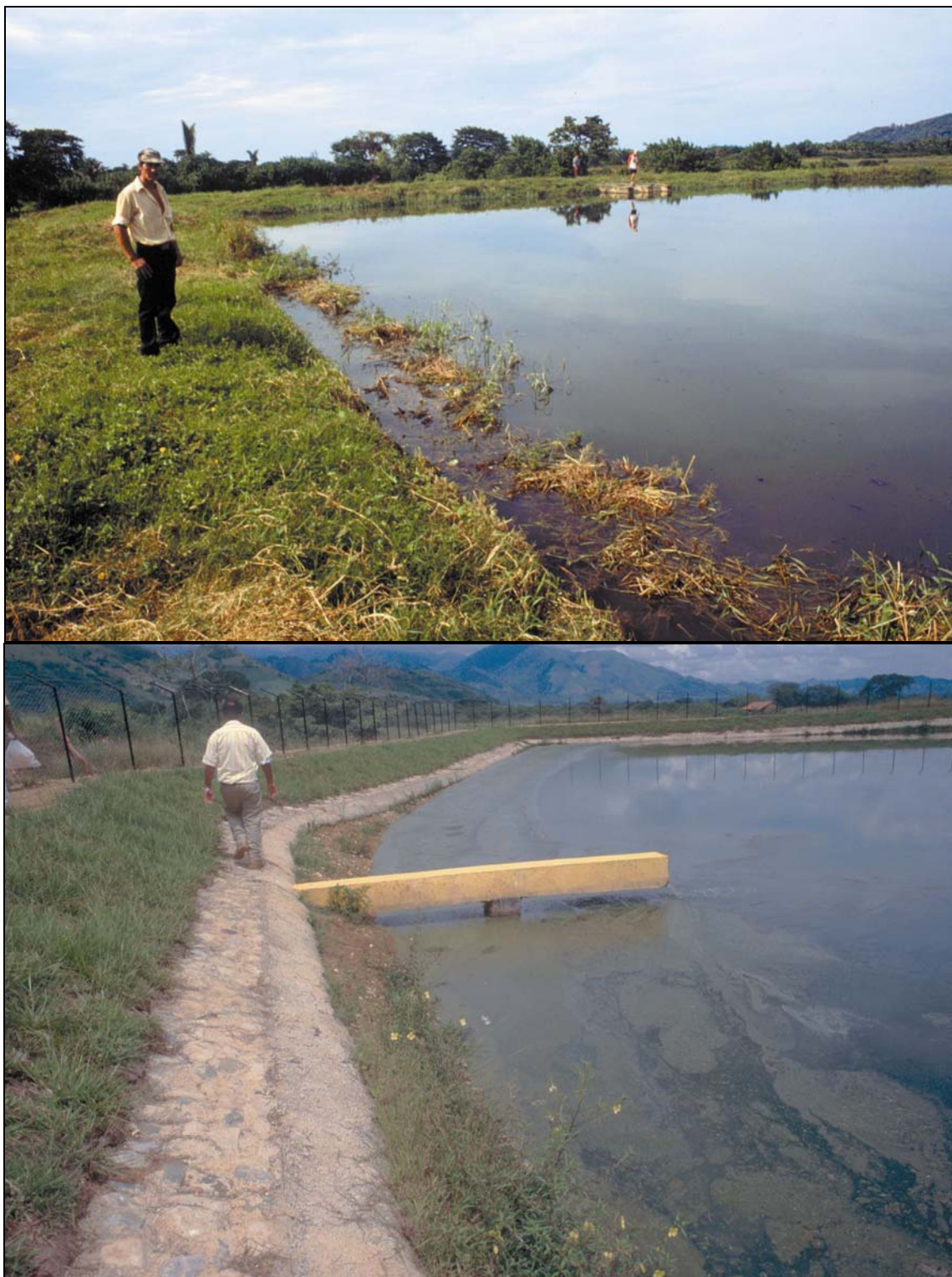
Fotos 6-18: En la foto arriba (Tela, Honduras) la laguna facultativa tiene problemas con el crecimiento de hierbas acuáticas en la orilla por falta de un revestimiento. En la foto abajo (Catacamas, Honduras) la deficiente construcción del revestimiento (notase las curvas de nivel) con insuficiente borde libre no previene el crecimiento de plantas acuáticas en la orilla.
