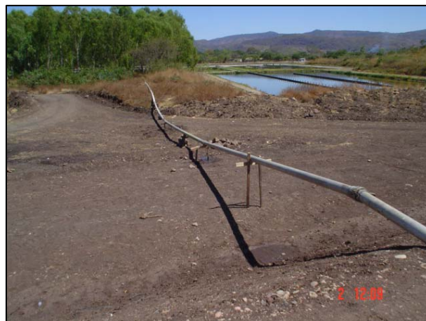
Figura 14 – Tubería de impulsión
