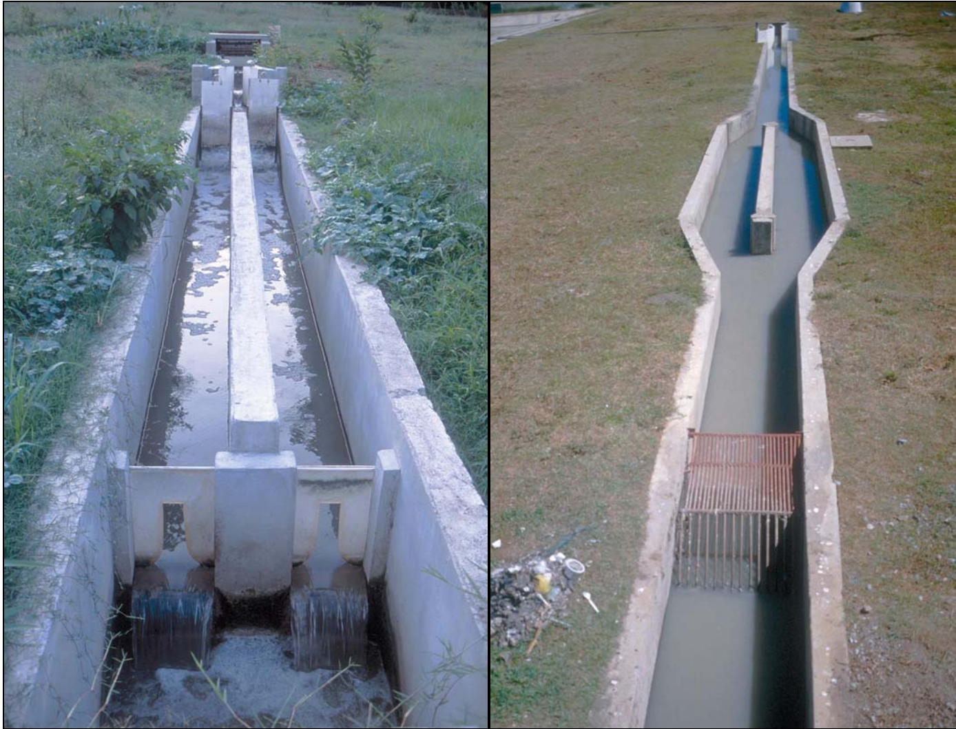
Fotos 7-2: En la mayoría de las instalaciones que cuentan con desarenadores, los operadores no están operando correctamente el desarenador, como se ve en estas fotos. Parte del problema es el mal diseño o mala construcción del desarenador donde no se puede sellar ni drenar las cámaras, y parte es un problema de capacitación del operador en la operación correcta de desarenadores. En la foto a la izquierda (Trinidad, Honduras), el operador dejó las dos cámaras en operación por falta de una manera de sellar y drenar las cámaras. En la foto a la derecha (Granada, Nicaragua) no existían compuertas para cerrar las cámaras ni una manera de drenarlas.
