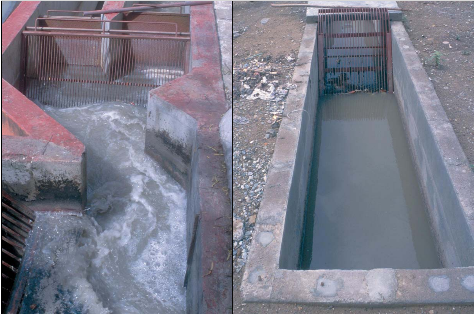
Fotos 3-8: Los canales de aproximación antes de la rejilla deben tener una velocidad de 0.45 m/s para que los sólidos arenosos no sedimenten y la velocidad a través de las barras no exceda 0.6 m/s. También, los canales deben tener un tiempo de retención hidráulica mínimo de 3 segundos y un largo mínimo de 1.35 metros para asegurar una velocidad uniforme a través de las barras. El canal a la izquierda tiene demasiada turbulencia para tener una velocidad uniforme. El canal a la derecha tiene suficiente largo para asegurar una velocidad uniforme sin turbulencia. (Foto izquierda: Urbanización en la Ciudad de Guatemala; Foto derecha: Trinidad, Honduras)
