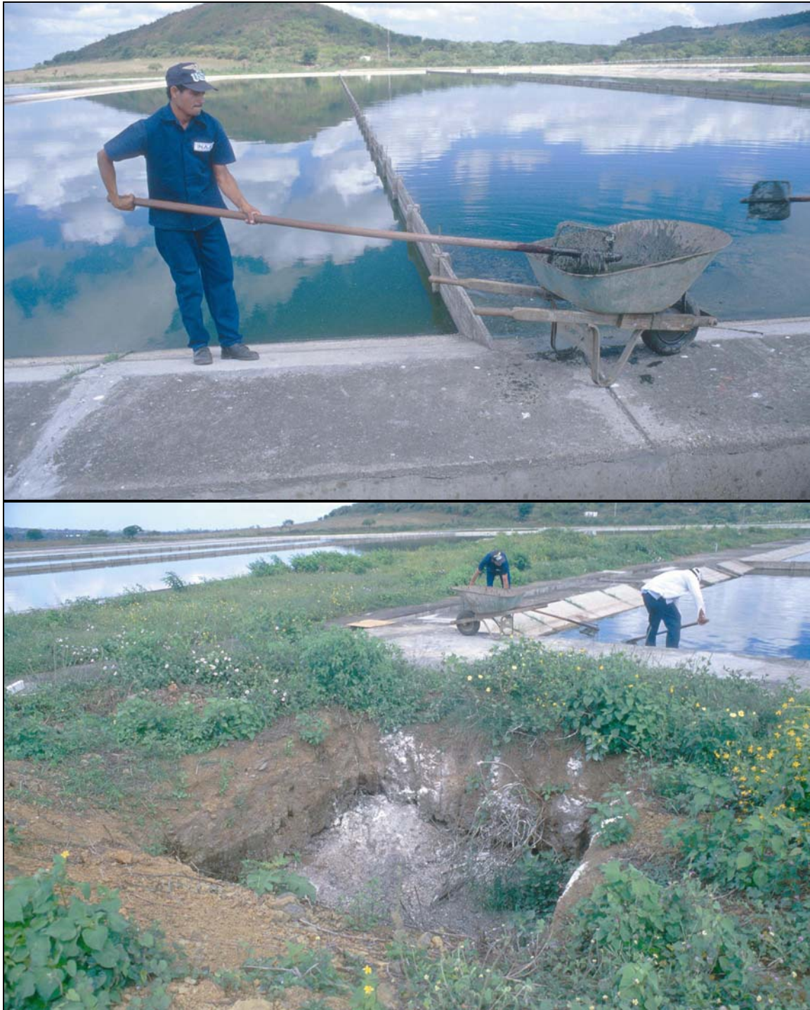
Fotos 7-5: Las natas y sólidos flotantes se acumulan en las esquinas de las lagunas, donde el operador puede sacarlos fácilmente con un desnatador y ponerlos en una carretilla. Después, se debe enterrarlos, o cubrirlos con una capa de suelo o cal. En la foto abajo los operadores ponen las natas recolectadas en un pozo y los cubren con cal para controlar olores. Cuando se llena la excavación se cubre con una capa de suelo. (Masaya, Nicaragua)
