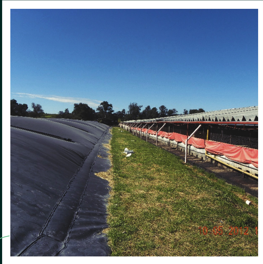
FIGURA 5.9 VISTA DE UN DIGESTOR TIPO LAGUNA CUBIERTA PARA EL TRATAMIENTO DE EFLUENTE PORCÍCOLA (FUENTE: II-UNAM)
